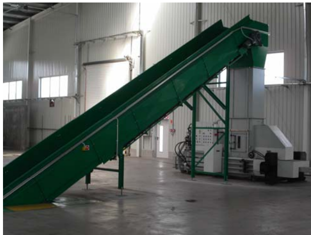
Fot 2. 7. Linia technologiczna prasowania i belowania odpadów
